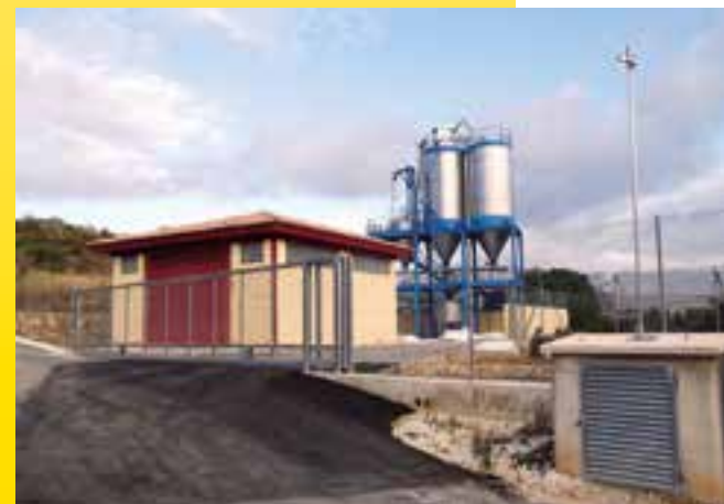
Centre de control i fertilització dels recs d'Altea.
